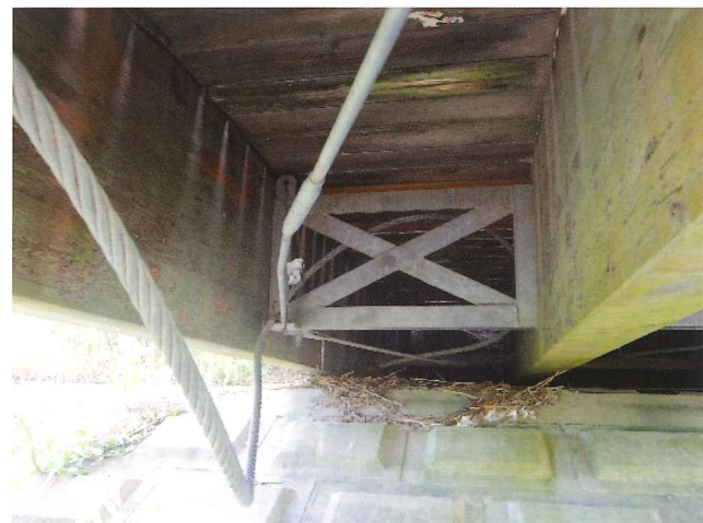
写真-44 田渡橋の桁下のロープ (H30 (2018))
